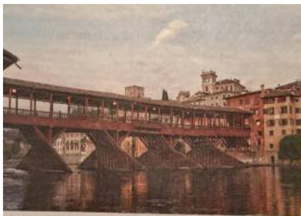
L'allarme: il Ponte di Bassano cede
